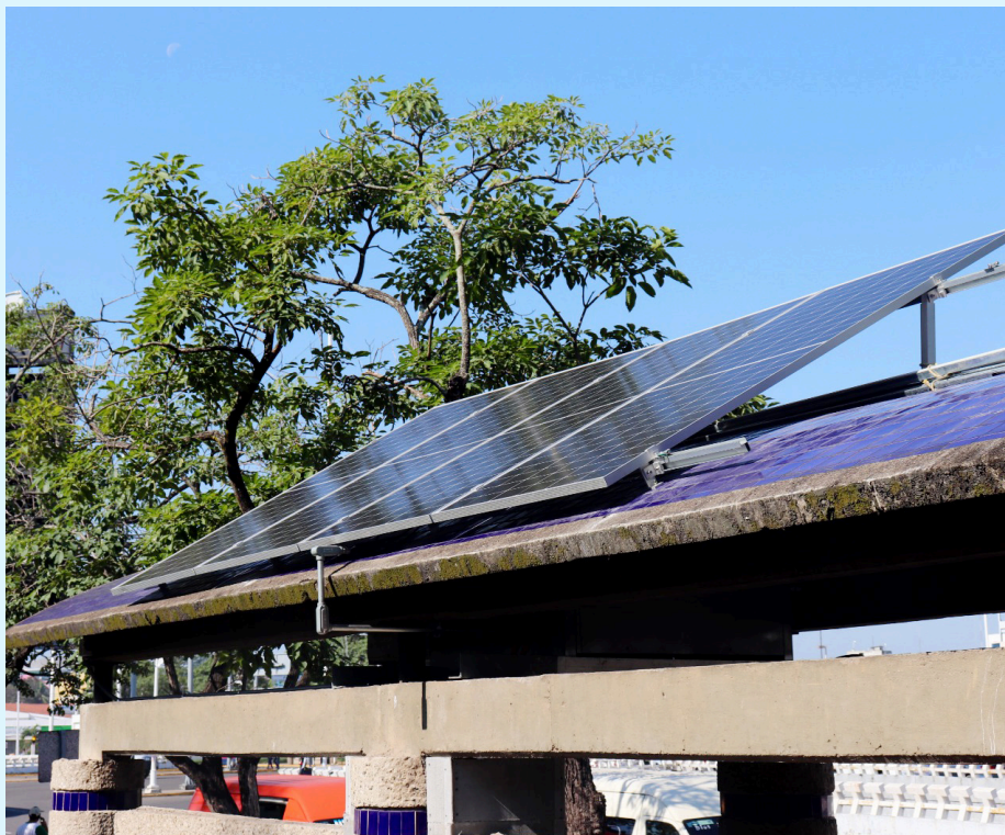
Panel solar, parte de la infraestructura de la "Parada inteligente".
