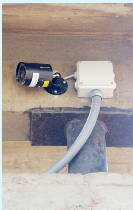
Cámara de vigilancia, parte de la infraestructura de la "Parada inteligente".
